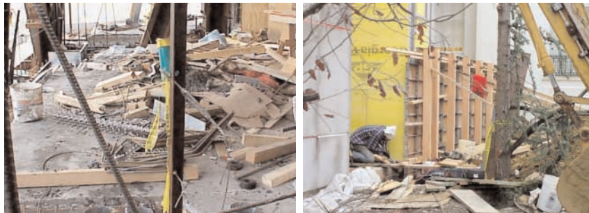
Figura 42 - Falta de orden y limpieza.
