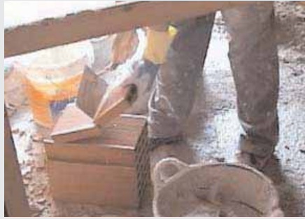
Figura 130: Uso inadecuado de la herramienta
