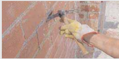
Figura 161: Agarre inadecuado de la piqueta
