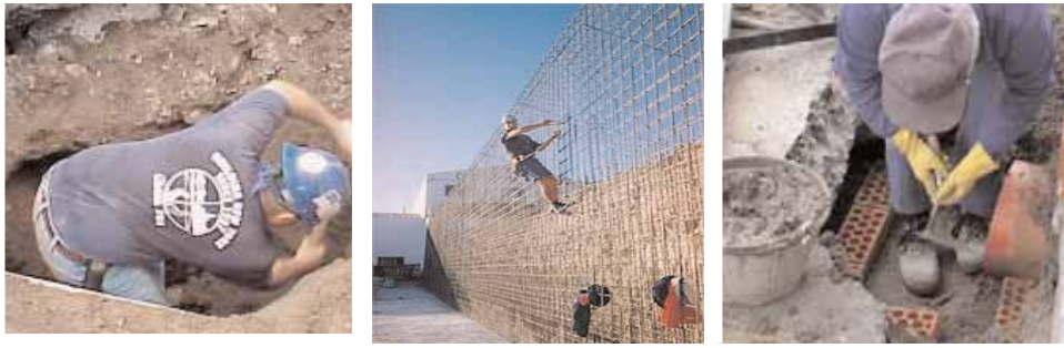
Figura 2: Ejemplos de tareas en el sector de la construcción con accesos incorrectos, superficies inestables y alturas inadecuadas
